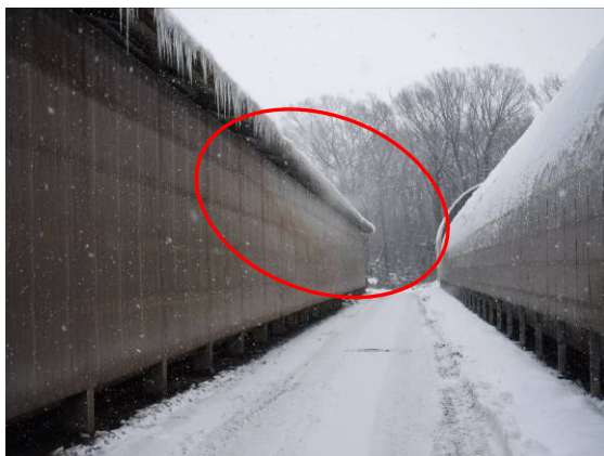
写真 43：南側壁の上部から排出されている状況
