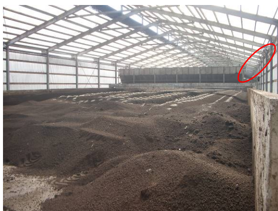
写真 13 : 堆肥舎北側の誘引ファン 2 台 (遠景)
