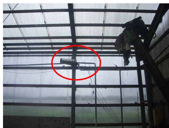
写真 12 : 堆肥舎搬入口右側の誘引ファン設置位置
