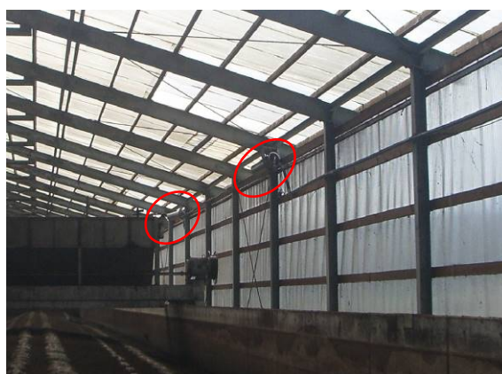
写真 14 : 堆肥舎北側の誘引ファン 2 台 (近景)
