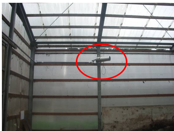
写真 11 : 堆肥舎搬入口左側の誘引ファン設置位置
