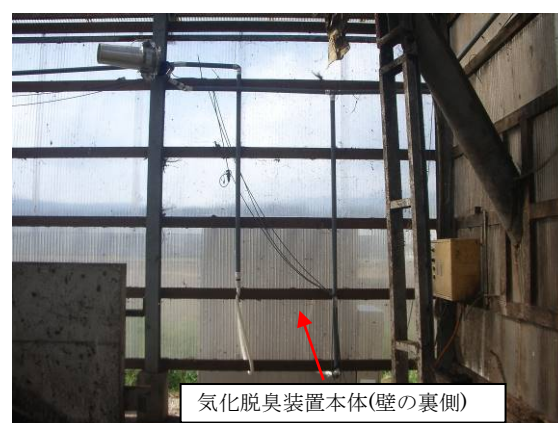
写真 16 : 気化脱臭装置本体と誘引ファン
