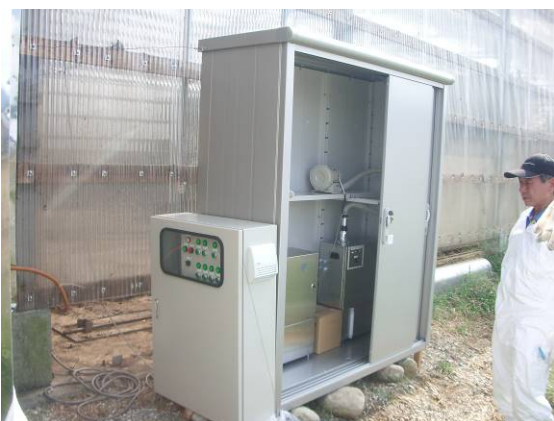
写真 9 : 気化脱臭装置本体の設置状況 (遠景)
