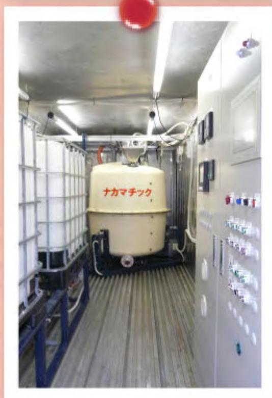
収納コンテナの装置内部
