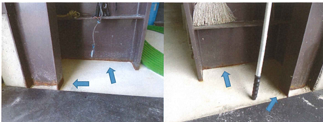
特に目立つ出入口周辺の鉄骨のサビ（左扉及び右扉）（H30.2.20 現在）
